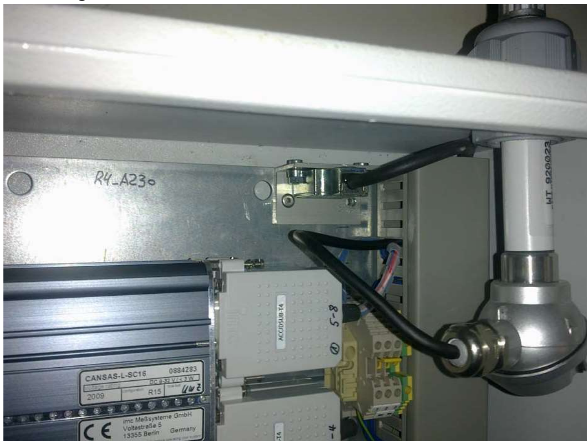
Abbildung 3: Sensor in Schaltschrank
