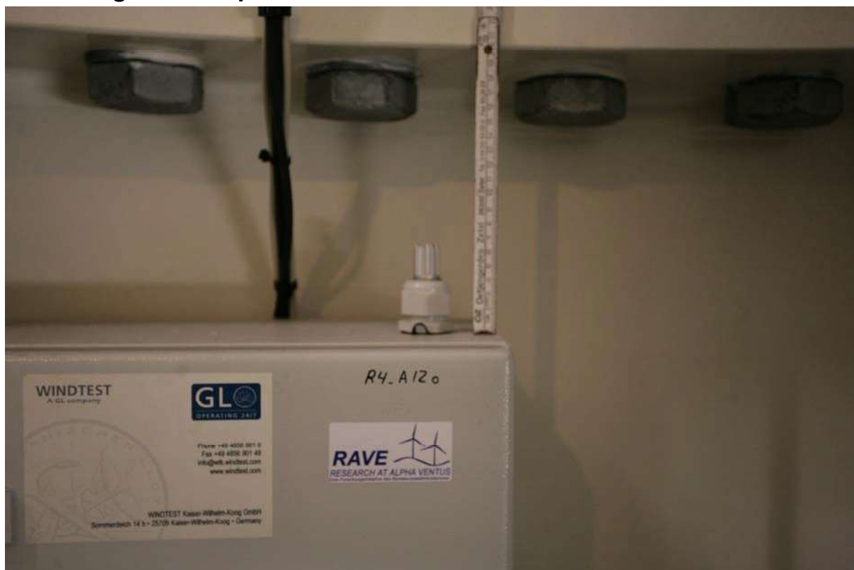
Abbildung 1: Fühlerposition an Schaltschrank
