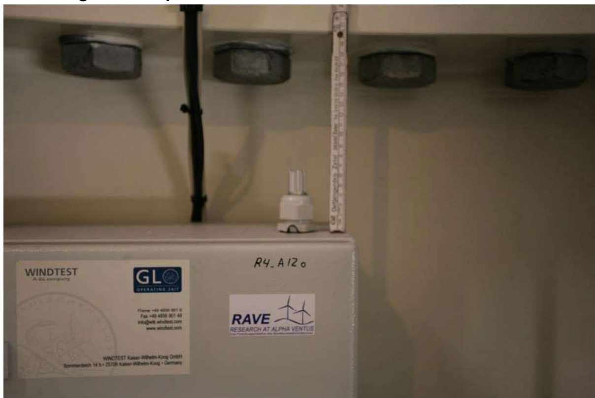
Abbildung 2: Fühlerposition an Schaltschrank
